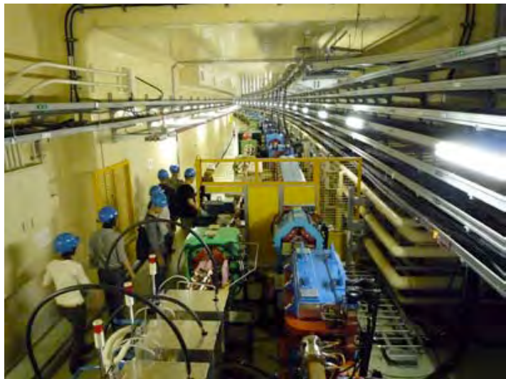
KEK・B-Factory 見学会での一コマ。 地下トンネル内の電子・陽電子加速器。
